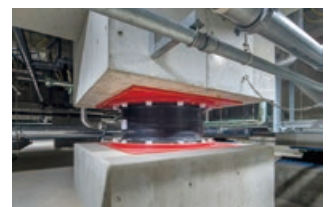
本館の免震装置
